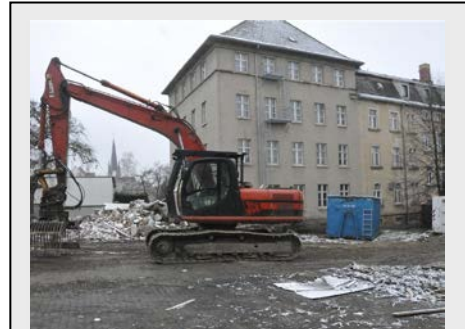
Die ehemalige Kunstblumenfabrik an der Külzstraße in Neustadt wird der ASB sanieren. Hier sollen Wohngemeinschaften für Demenzkranke eingerichtet werden. © Dirk Zschiedrich
